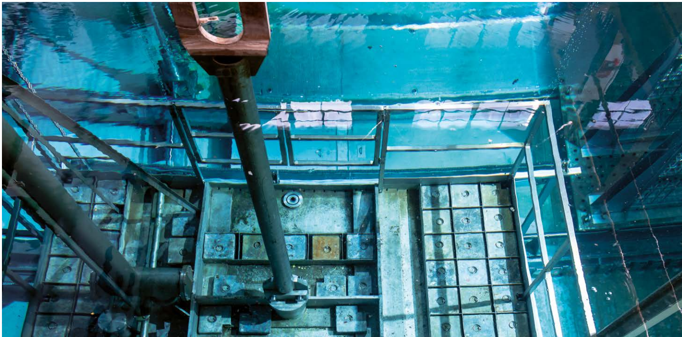
INB 77 - Poséidon - LABRA - Cellule étanche Caline. ©CEA/P. Stroppa
