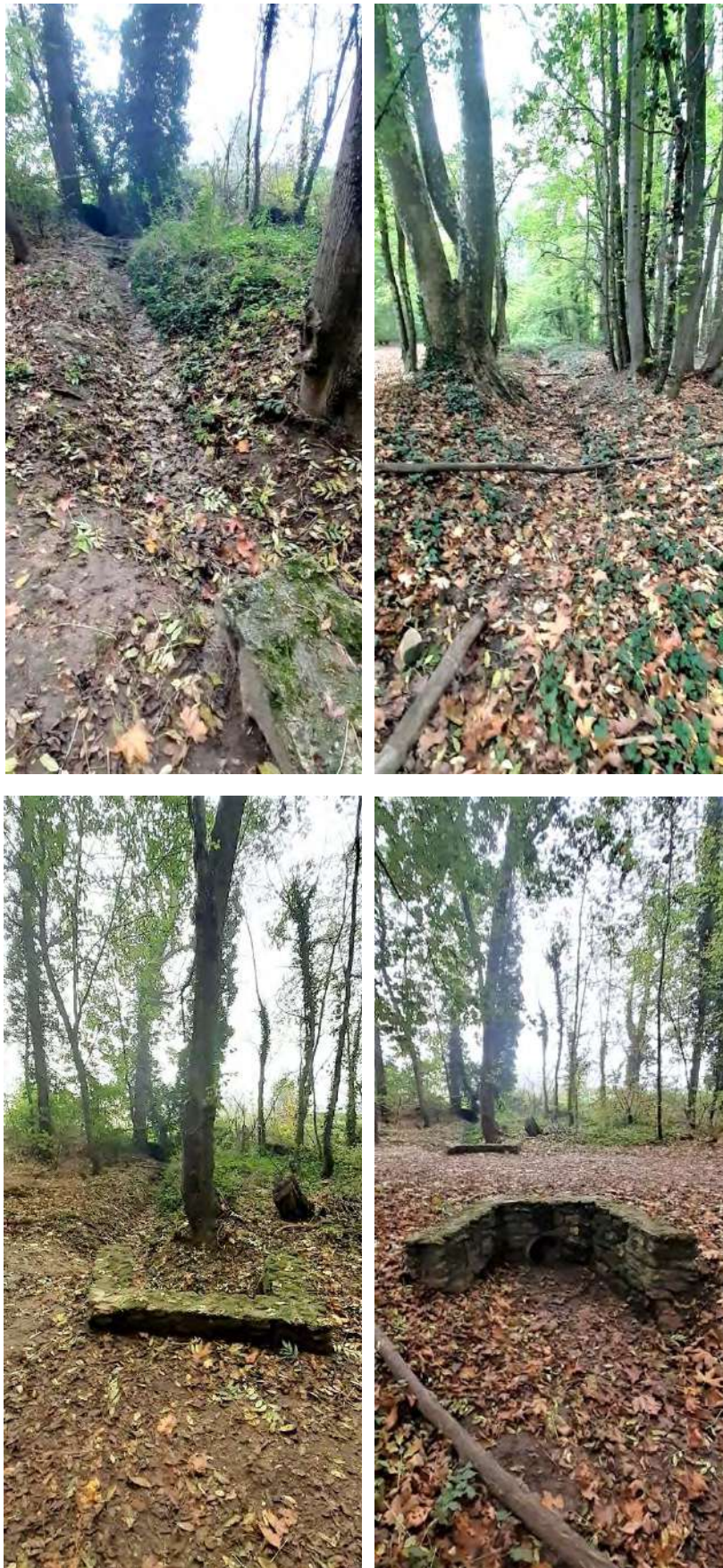
Fig. 98 à 101 : Canaux et ponceau d'évacuation sous l'allée au bord de la Salmouille
