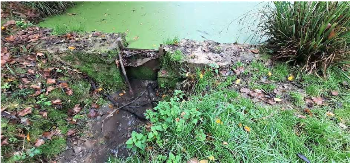
Fig. 89-90-91 : Installations hydrauliques de part et d'autre du plan d'eau de Bellejame, XVII e -XIX e siècles
