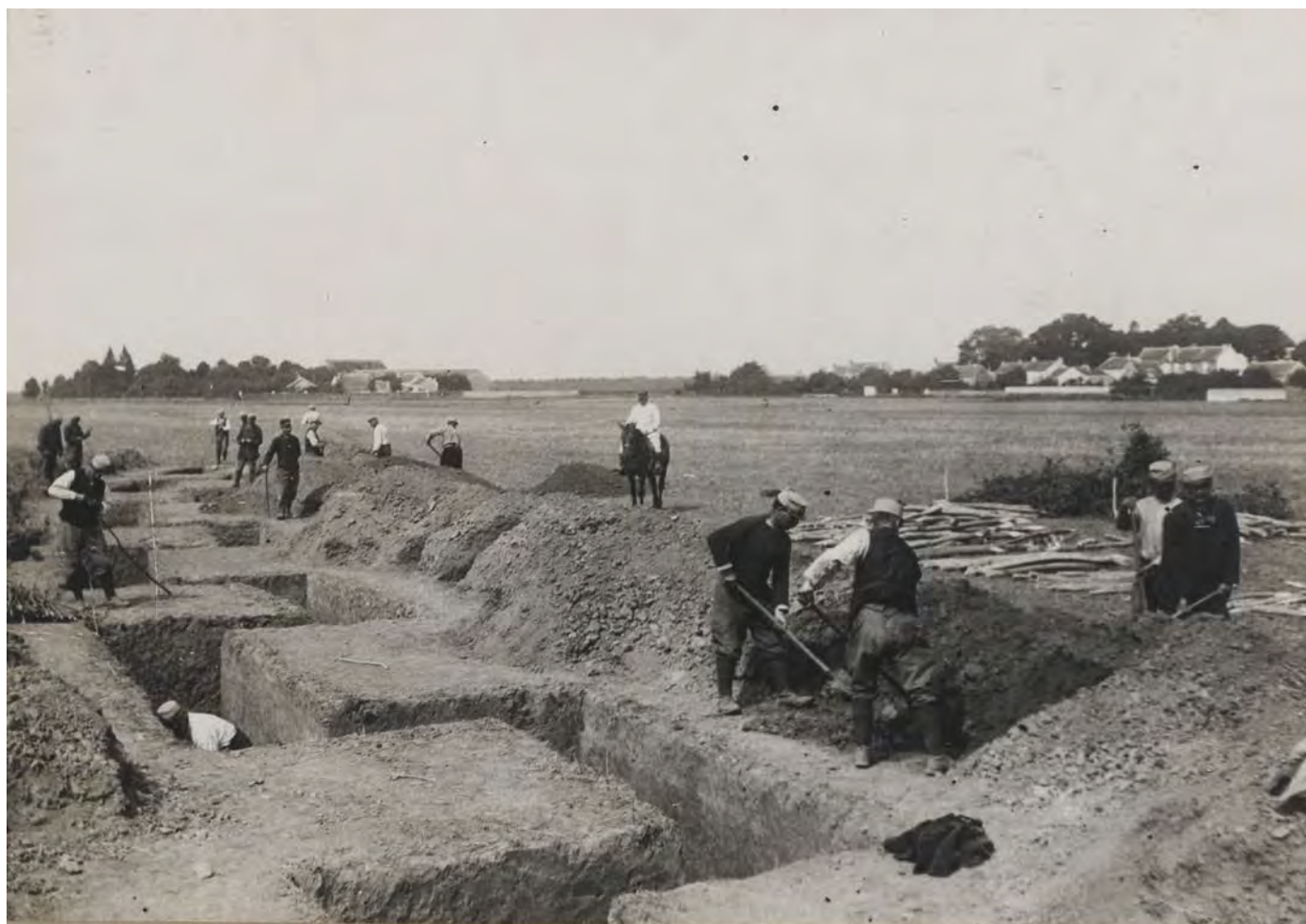
83 - Tigery, construction de tranchées et d'abris par des territoriaux, 20 août 1915. - BDIC - VAL 393/071.
